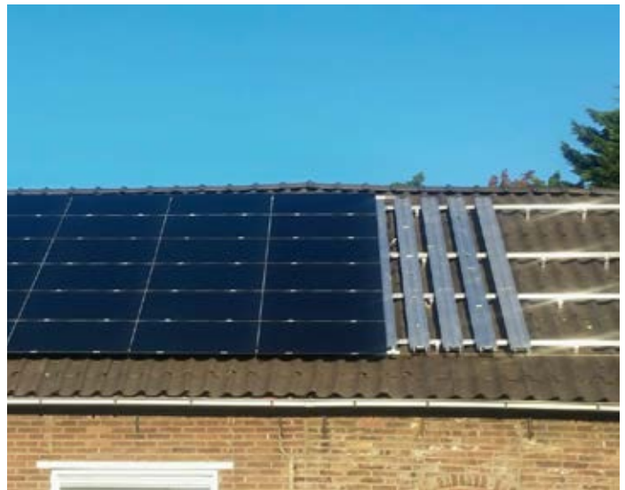
De Thermodule® op het dak
